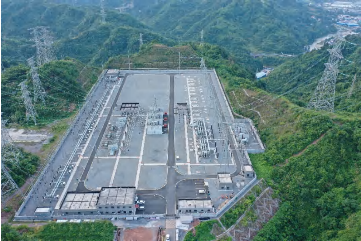
图 3.1-9 边城变电站俯瞰图
