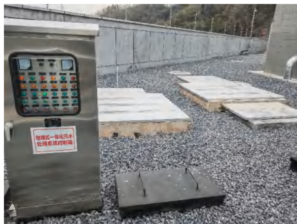
生活污水处理装置
