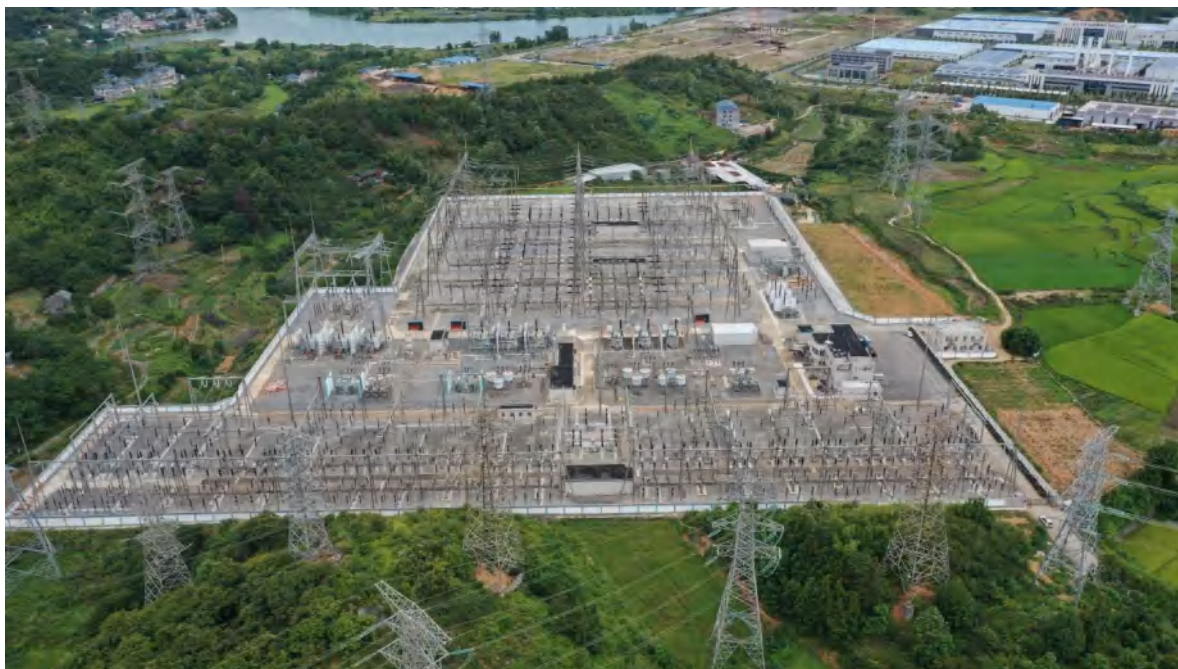
图 3.1-6 牌楼变电站俯瞰图
