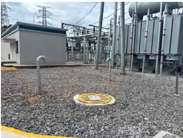
主变区事故油池
